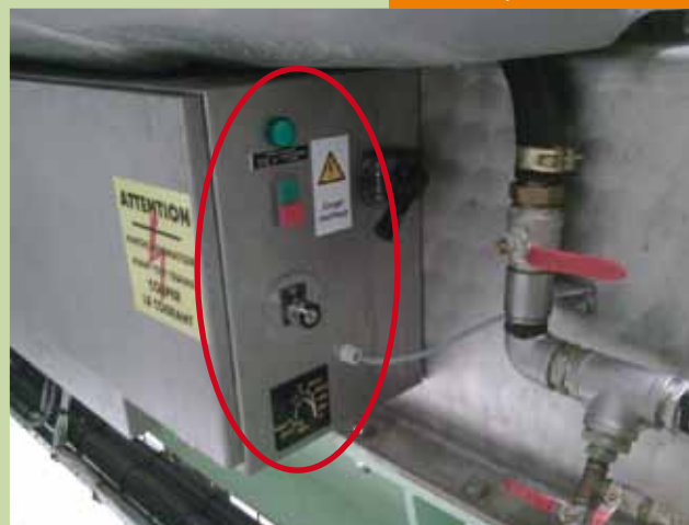
Panneau de commande après adaptation : commande d'avancement à clef et témoins lumineux (le sectionneur coupe le courant et l'air comprimé)
